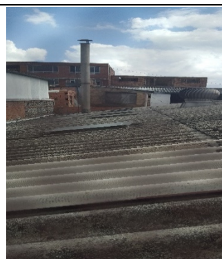
FOTO. 6 DUCTO DEL HORNO
