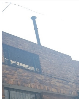
FOTO NO. 4 DUCTO DE LA CALDERA
